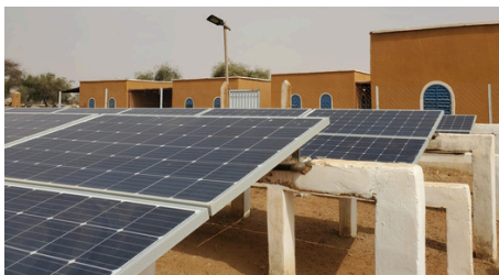
Plateforme énergétique de Mbiddi.
